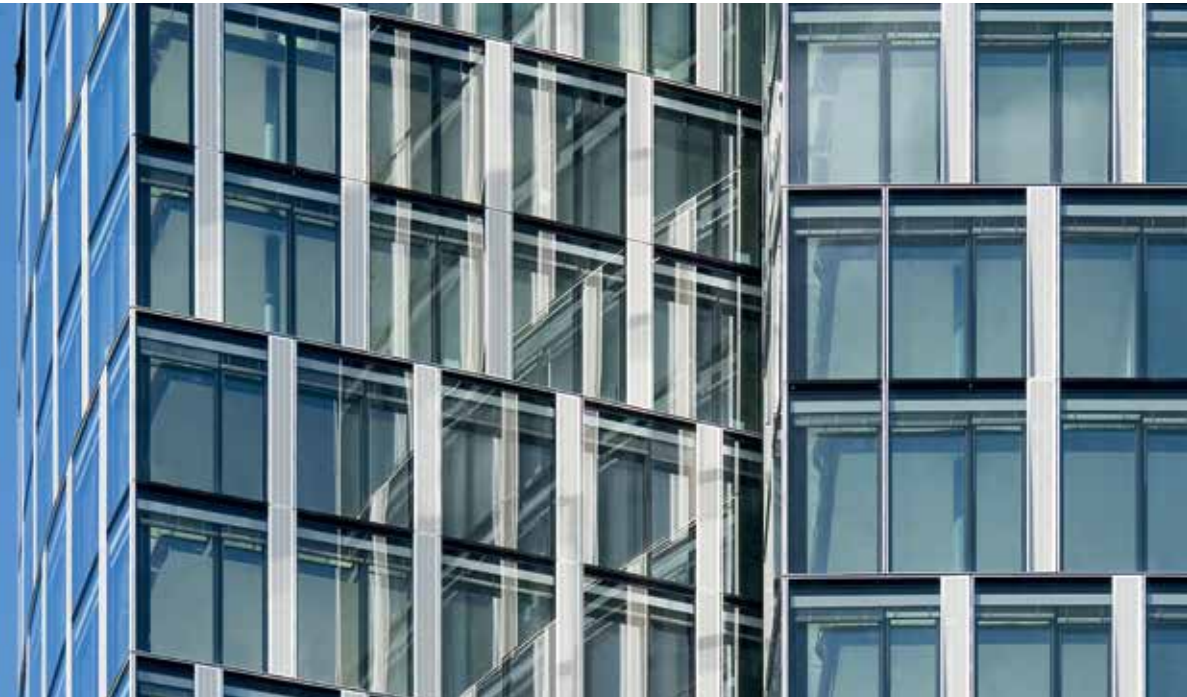
Doppelfassade mit Lüftungsboxen aus Aluminium Dual façade with aluminum ventilation boxes
